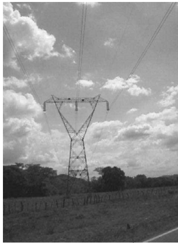
Figura 30. Torre de 400 kV, de la empresa EDELCA
